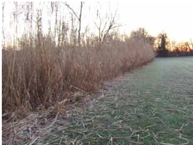
Fig. 4 Estat actual de la mota del tram núm.1 amb presència de canya ( Arundo donax )
