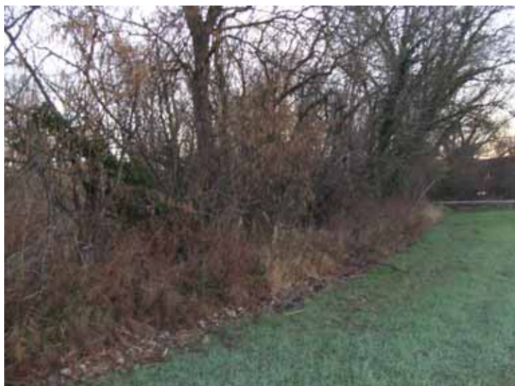
Fig. 5 Vista estat actual de la mota del tram núm. 2. S'observa peus de freixes.
