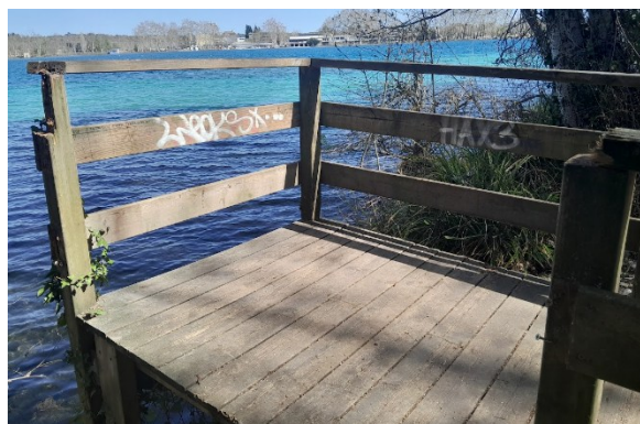
Passera amb la barana arrencada
