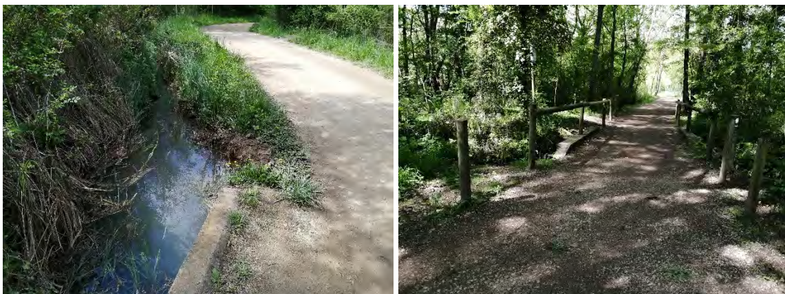
Imatge 11. Punt a consolidar marges i substitució de tanques
