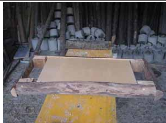
Marc de fusta de castanyer omplert de poliuretà comprimit per fer la base surant. Al fons, morts per subjectar les plataformes.
