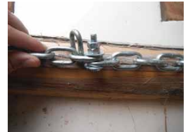
Detall de la unió de la cadena per sota la plataforma amb cargoleria inoxidable.
