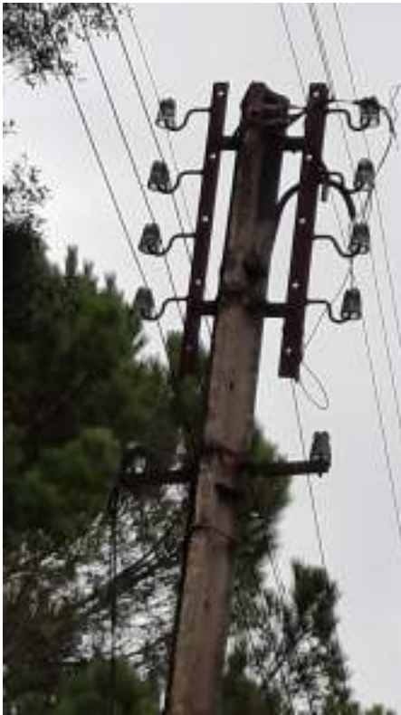
Foto de les línies aèries existents
