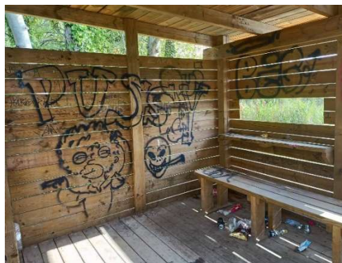
Desperfectes al mirador dels Amaradors
