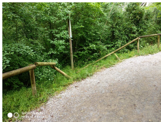
Tanca a reparar
