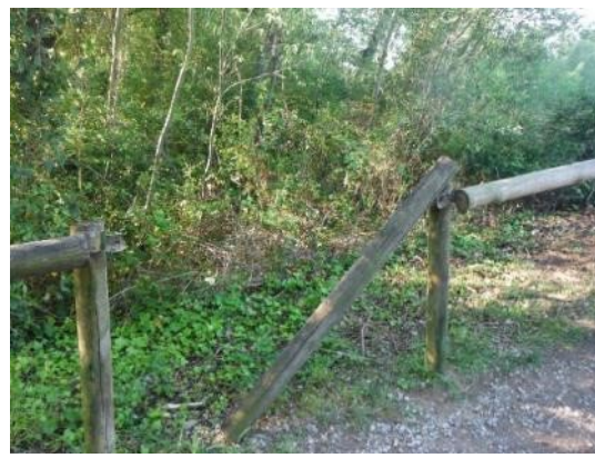
Tanca a reparar
