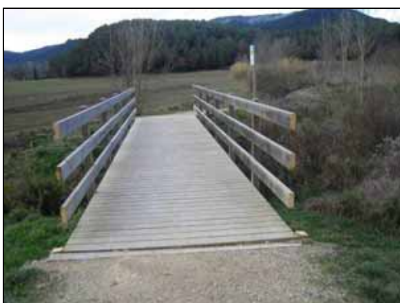
Estat del pont després del furt
