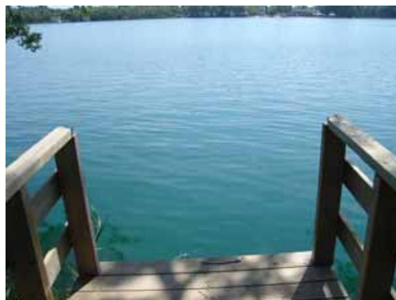
Destrossa de la barana d'una passera
